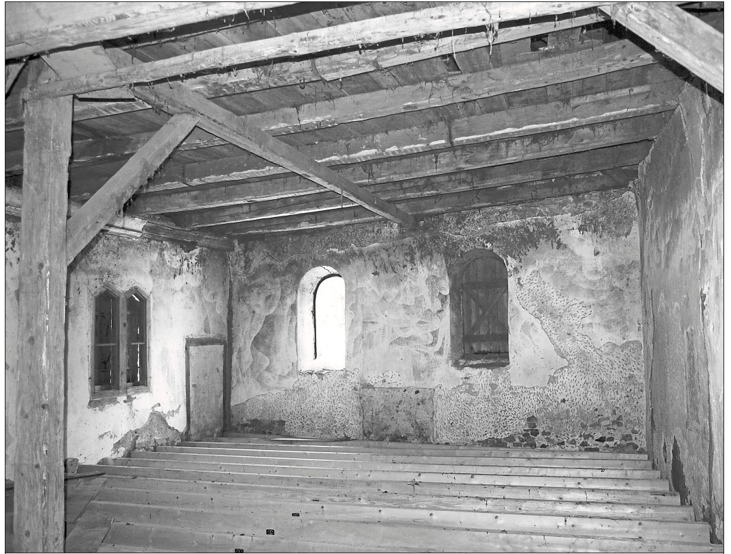
Blick in den einstigen Sakralraum mit Rundbogenfenstern und Altarumriss in der Ostwand sowie Doppelfenster und Priesterzugang in der Nordwand. Foto: King
